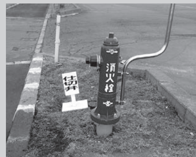
改修後の消火栓
