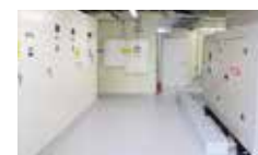
非常用発電機
