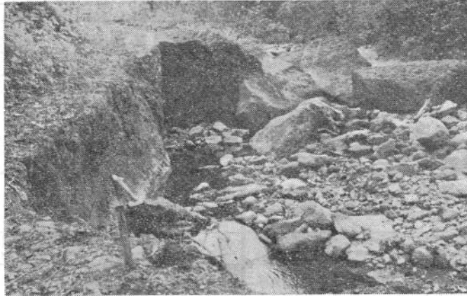
常呂林道の災害状況（道路が途中で寸断されている）
