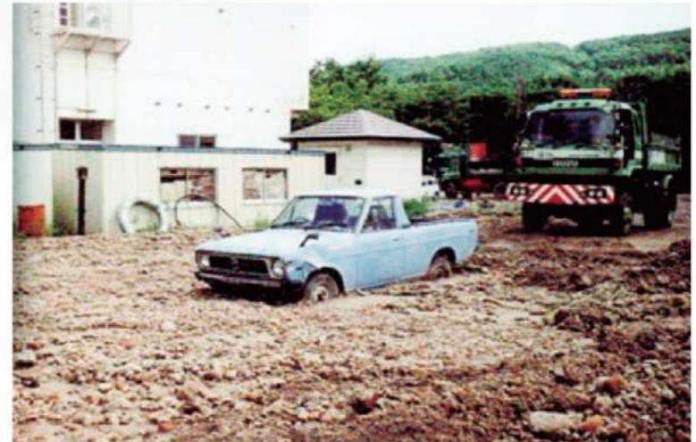
北海道駒ヶ岳平成8年(1996年)小噴火後の留ノ沢、温泉施設の被害状況
