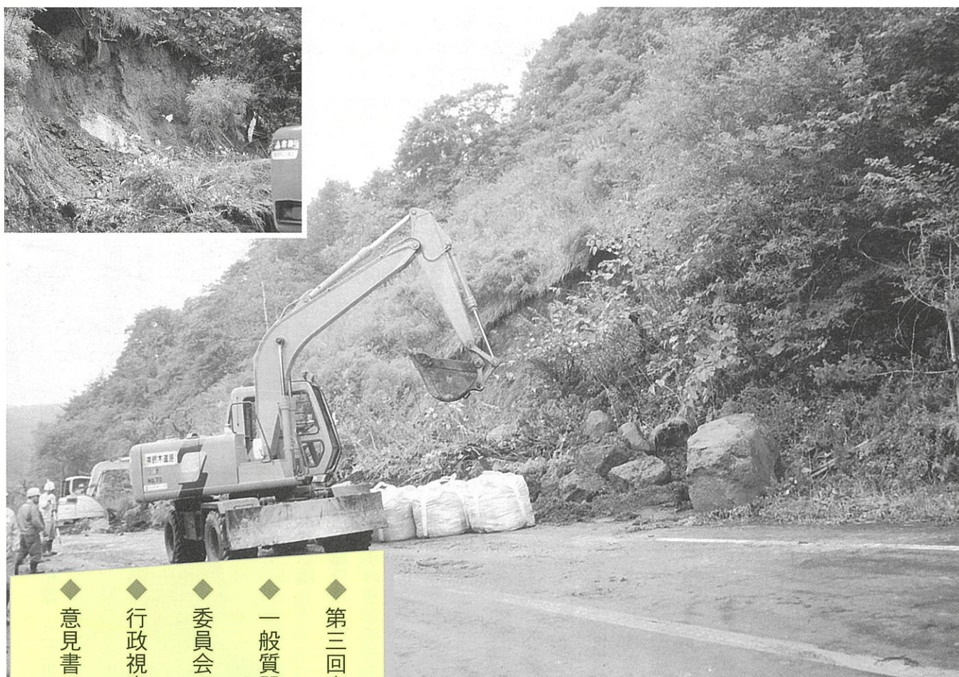
台風15号による土砂崩壊 (道々大沼公園鹿部線)
