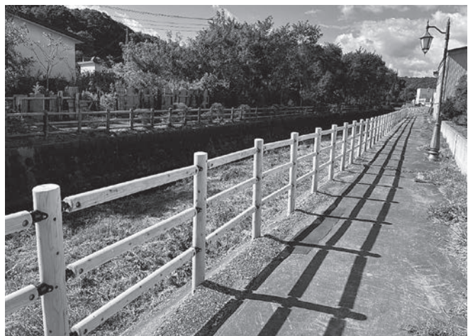
昨年に引き続き、せせらぎ散歩道転落防止柵の改修を行いました。
