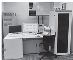
役場内放送設備
